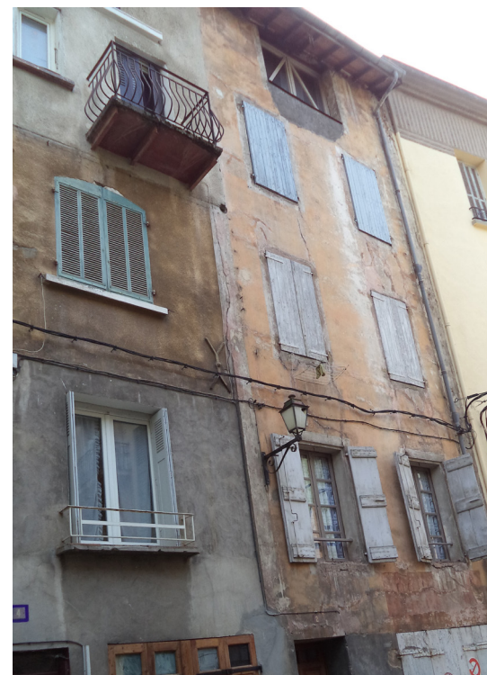
Figure 15. Façades dégradées dans le secteur Pied de Ville // AMOnites 2018
