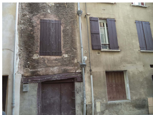
Figure 43. Façade dégradée, rue Curaterie // AMOnites 2018
